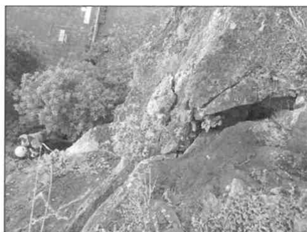
Photo 4 : fracture en rive droite de i1
